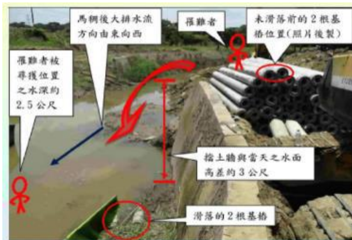
103. 07. 21某工地從事基樁 吊運作業發生溺水致死災害
