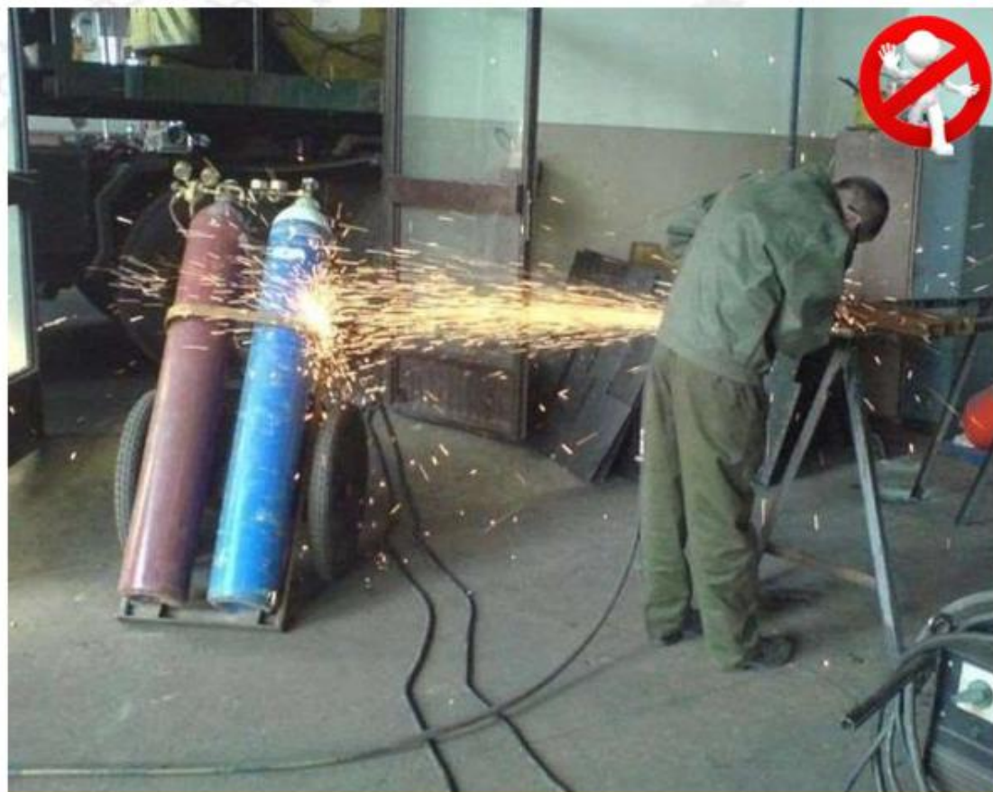
工作場所可燃性氣體鋼瓶未妥善處置
