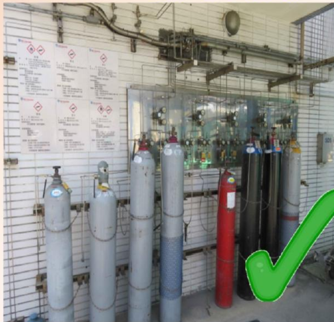
儲存高壓氣體之容器已固定
